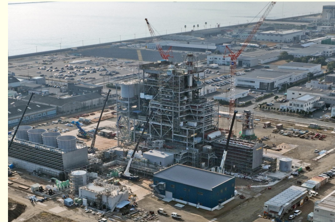
「長府バイオマス発電所」
